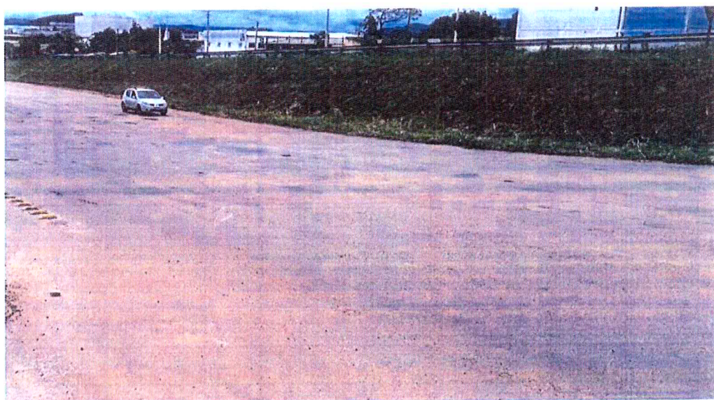
Figura 02 -Situação do pavimento antes da faixa de pedestres, Rua das Rosas, TO-050, Palmas-TO.
