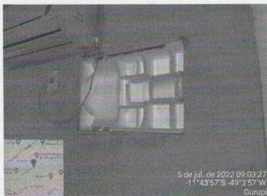
Foto 15 – VISTA PARCIAL ABERTURA DE AR CONDICIONADO
