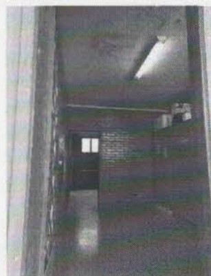
Foto 4 – VISTA PARCIAL FORRO COM INFILTRAÇÃO
