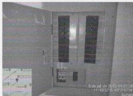
Foto 14 – VISTA PARCIAL INSTALAÇÕES ELÉTRICAS
