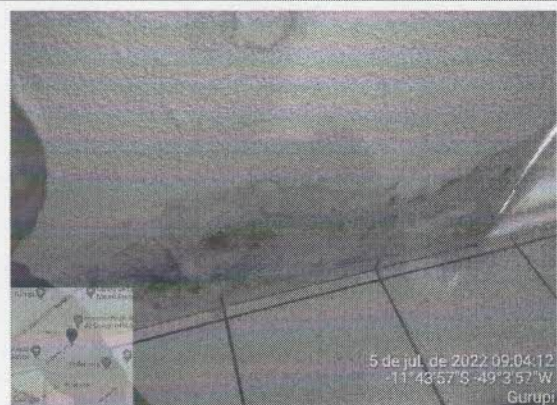
Foto 10 – VISTA PARCIAL EXCESSO DE UMIDADE NAS PAREDES
