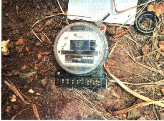
Imagem 11 – Vandalismo Ponte da Amizade e da Integração Nacional
