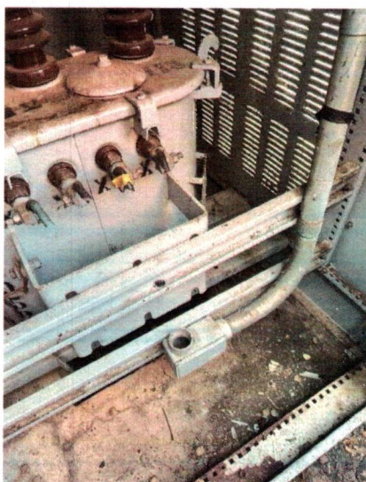
Imagem 9 – Furto de cabos Ponte da Amizade e da Integração Nacional
